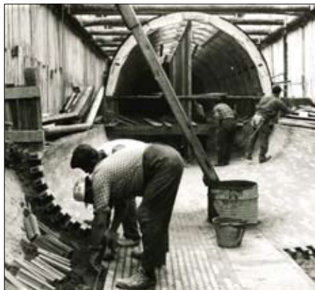
Costruzione dell'Emissario Occidentale Interno con sezione 3,80 x 3,40 lungo la via Brunelleschi. Posa del rivestimento del fondo 1971.
